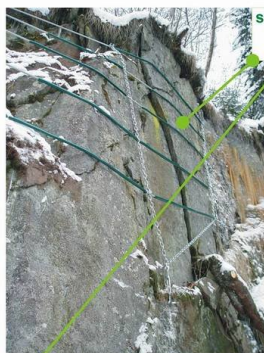
detail trhliny vyplněné ledem
